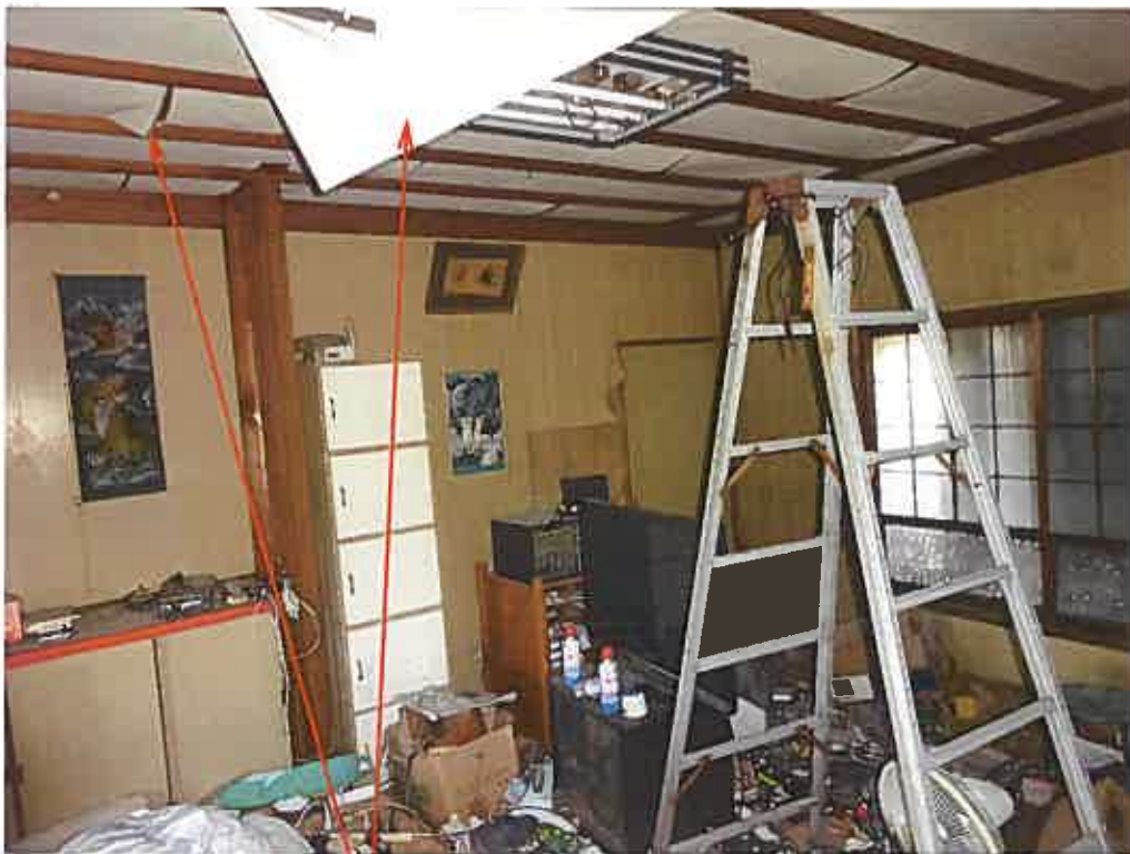
2階洋室天井部の傷み
