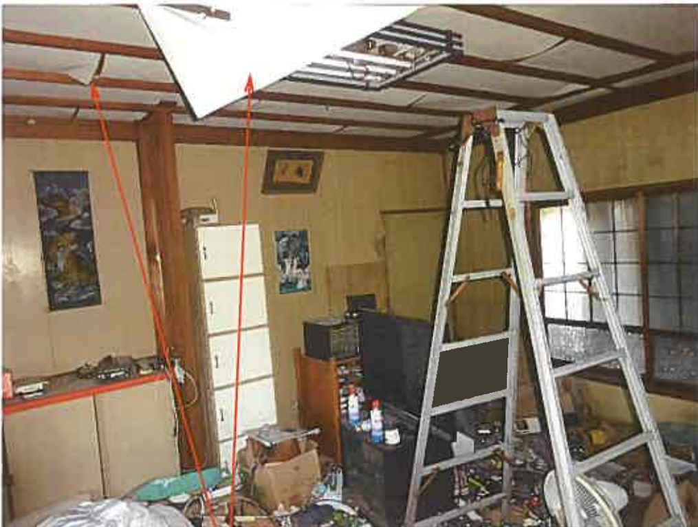
2階洋室天井部の傷み
