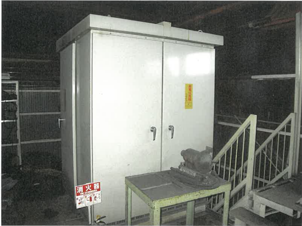
前同建物の1階事務室上の変電設備
