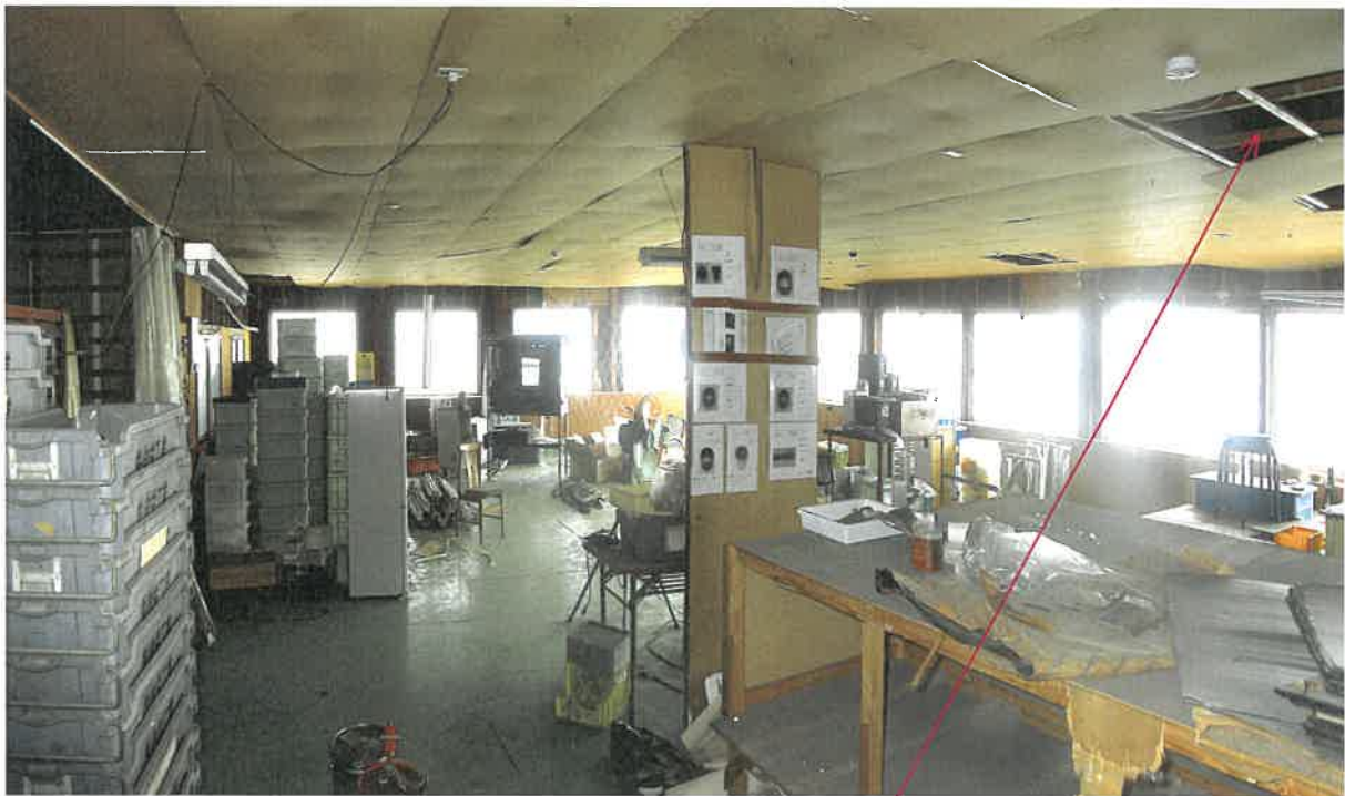
前同建物の2階作業場内（天井の剥離部分）
