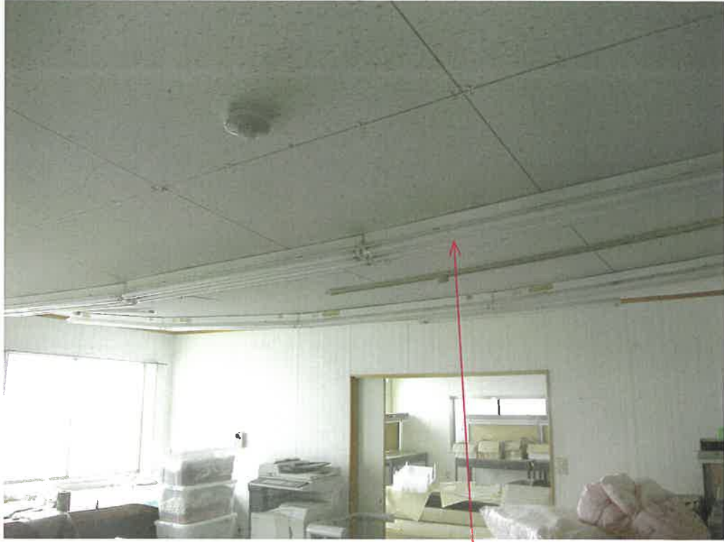
前同建物の2階倉庫内（天井の撓み部分）
