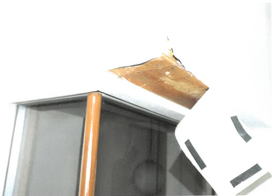
物件 2 建物 2 階 LDK 壁の損傷状況
