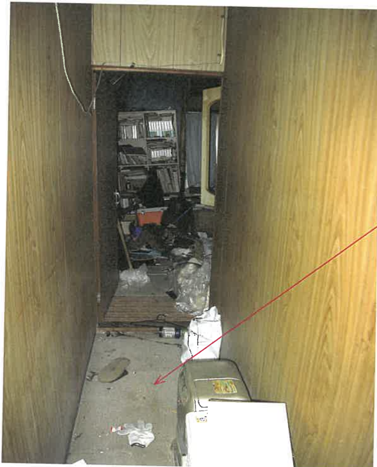
前同建物の1階廊下 (床の不安定箇所)
