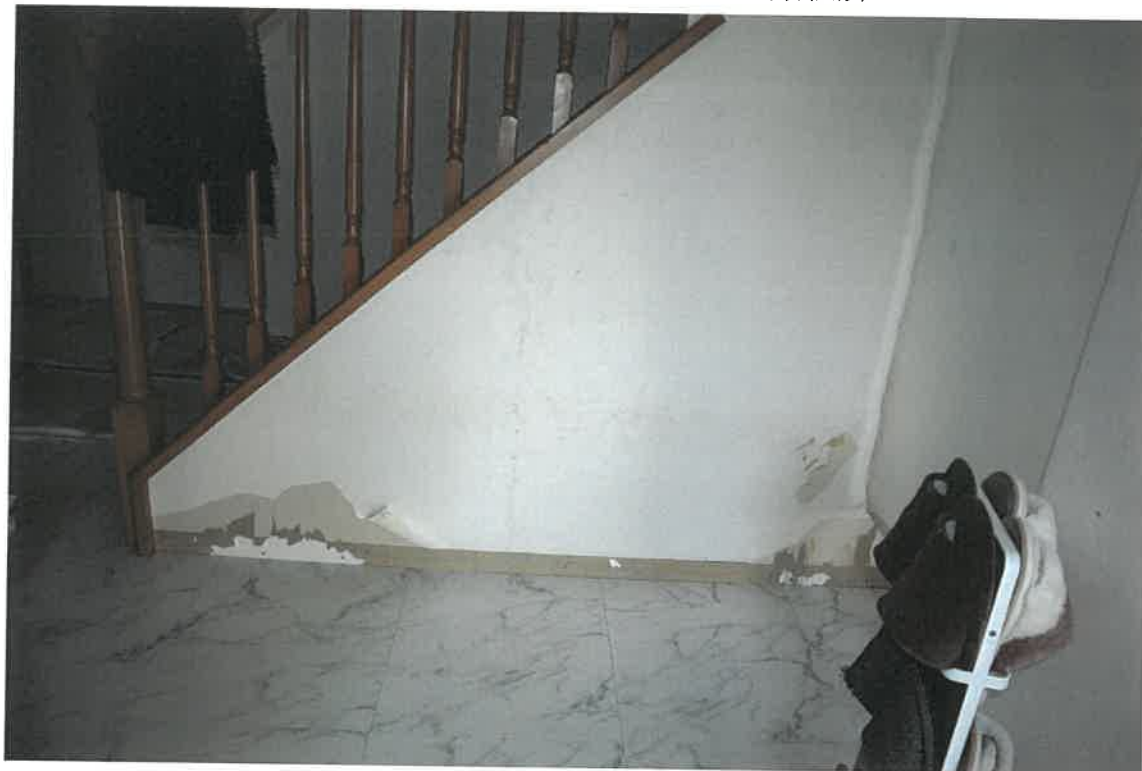
物件 6 建物 1 階の階段壁の損傷箇所
