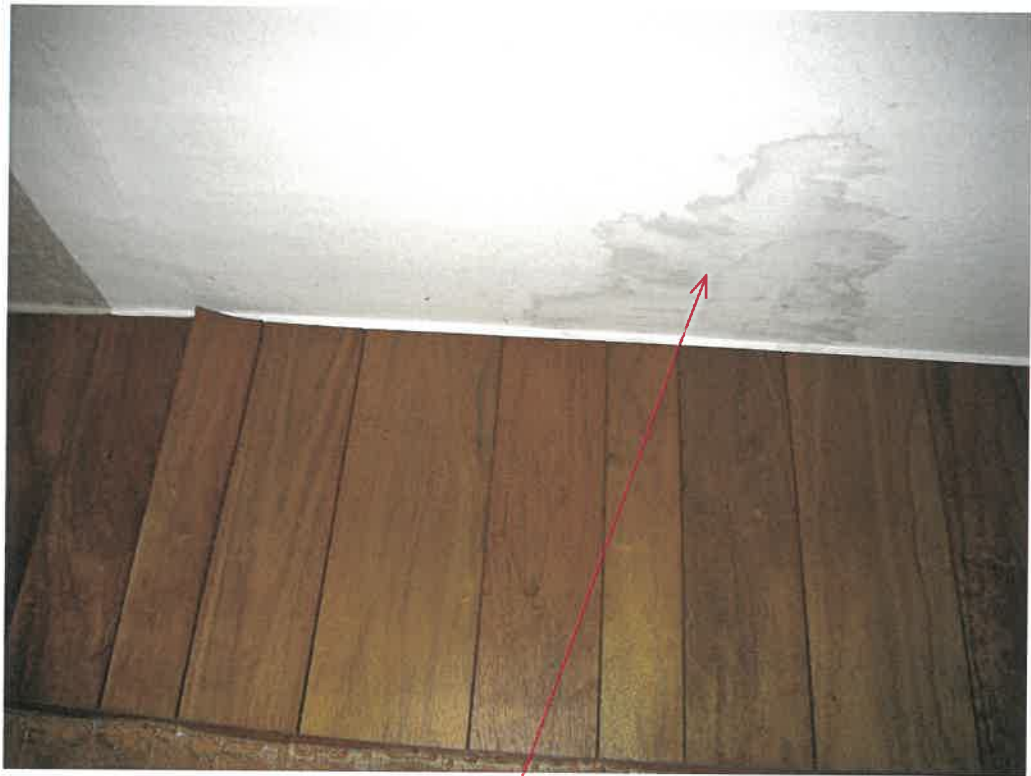
前同建物の1階玄関付近の天井の染み
