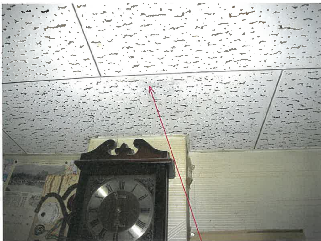
前同建物の1階室内（雨漏りの天井の染み）
