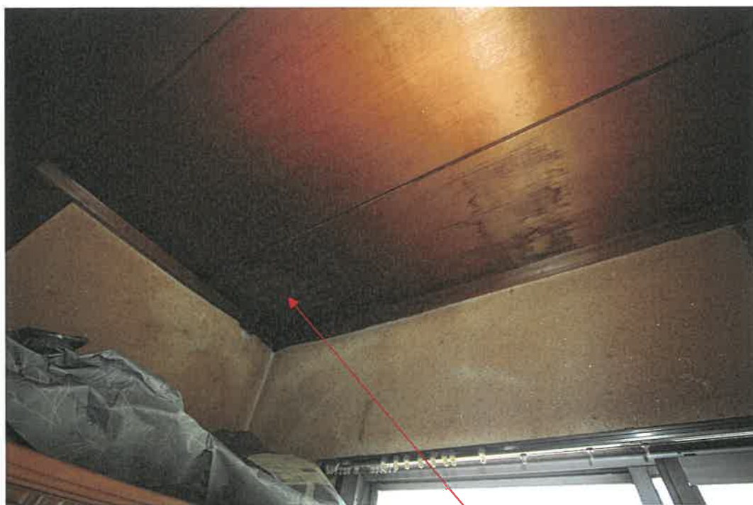
物件 5 主建物 3 階室内 雨漏り痕
