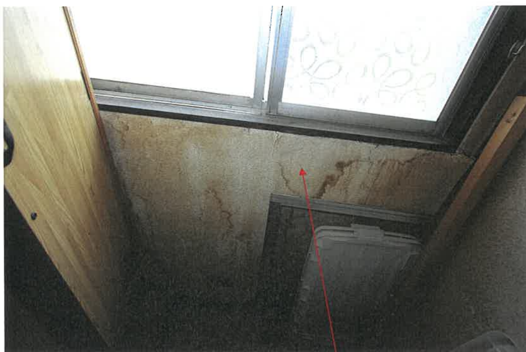
物件 5 主建物 3 階室内 雨漏り痕
