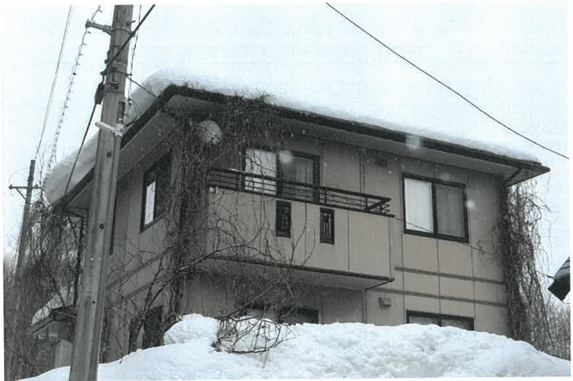
物件2 建物の外壁に木の枝が絡んでいる状況
