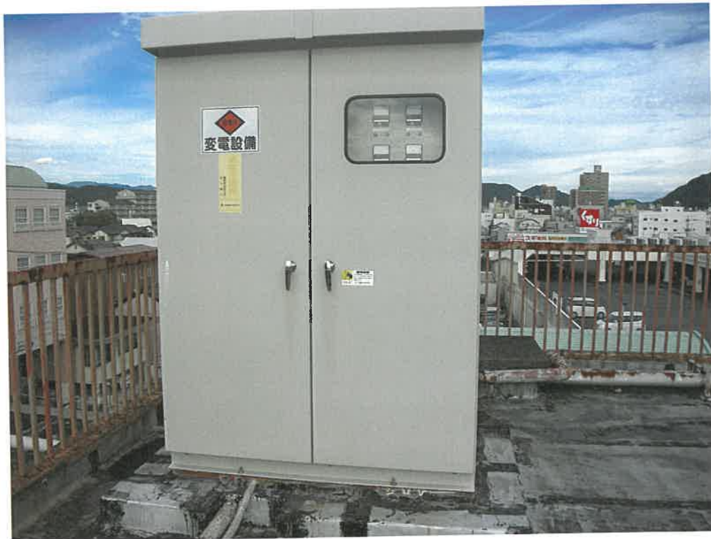
前同建物の4階屋上の変電設備
