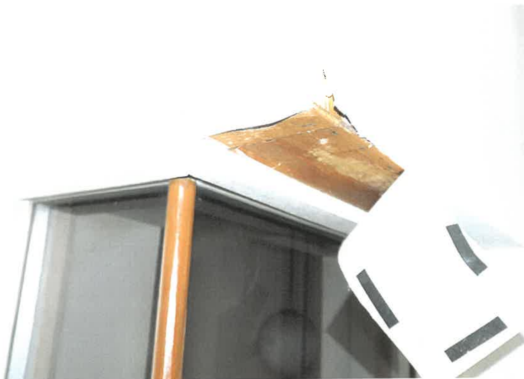
物件 2 建物 2 階 L D K 壁の損傷状況
