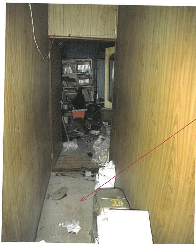
前同建物の1階廊下 (床の不安定箇所)
