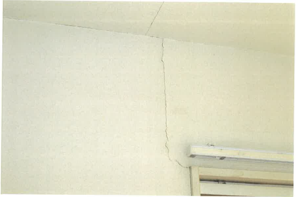
物件 2 建物 2 階北西側の洋室の壁の損傷箇所
