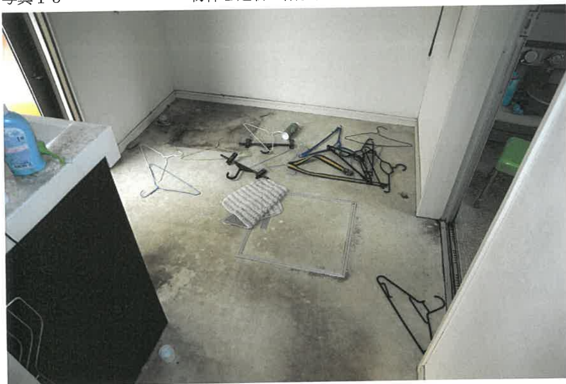
物件2建物1階洗面室床の損傷箇所
