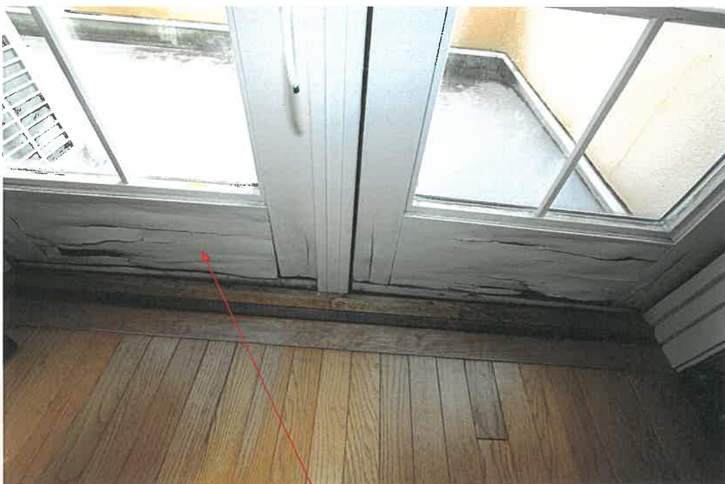
物件 2 建物 2 階室内 窓枠が雨水を吸って腐っている状態
