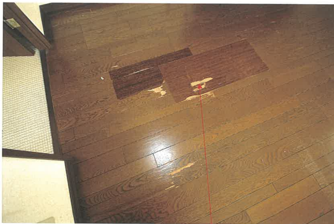
専有部分の建物 室内 床のいたみ
