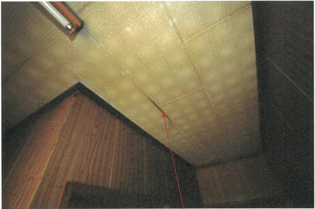
物件 2 建物 2 階室内 天井の剥がれ
