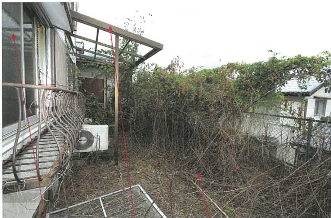
物件 2 建物 壊れた庇 物件 1 土地
