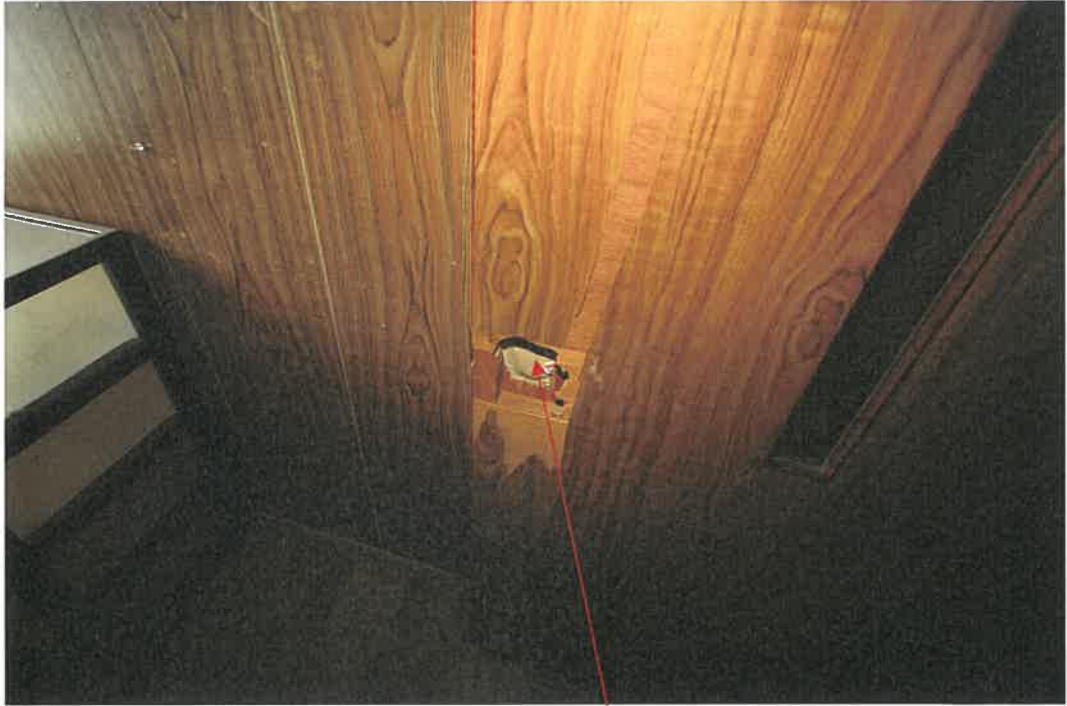
物件 2 建物 2 階室内 ドアノブがない
