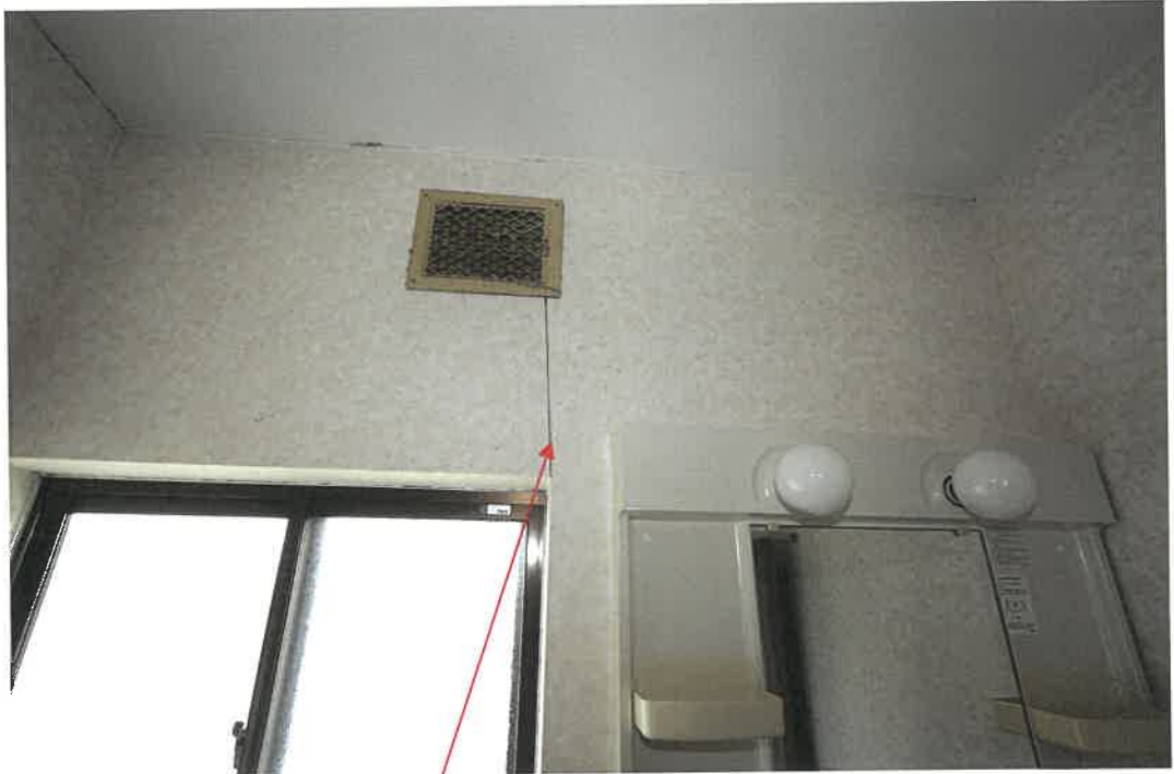
物件 2 建物 1 階室内 クロスの張り合わせ部分が剥がれている
