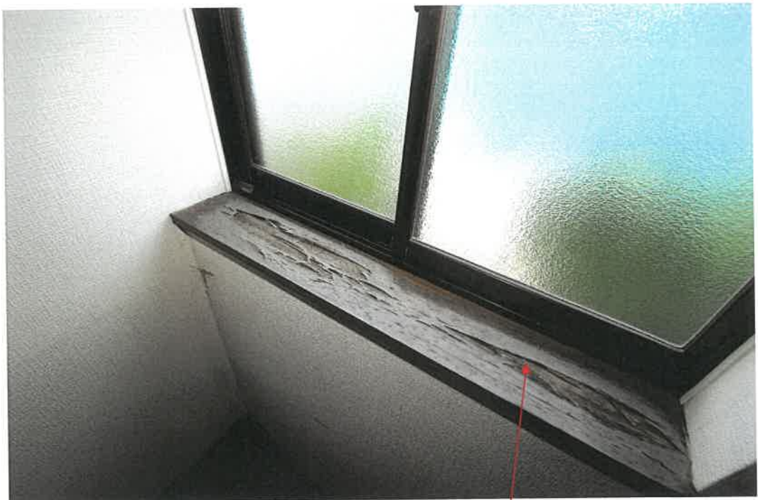
物件 2 建物 1 階から 2 階への階段部分 板が傷んでいる
