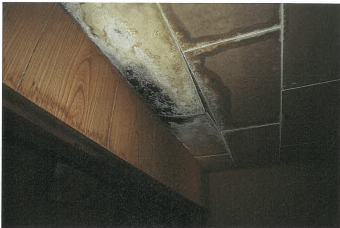
物件 4 建物天井部分の損傷箇所
