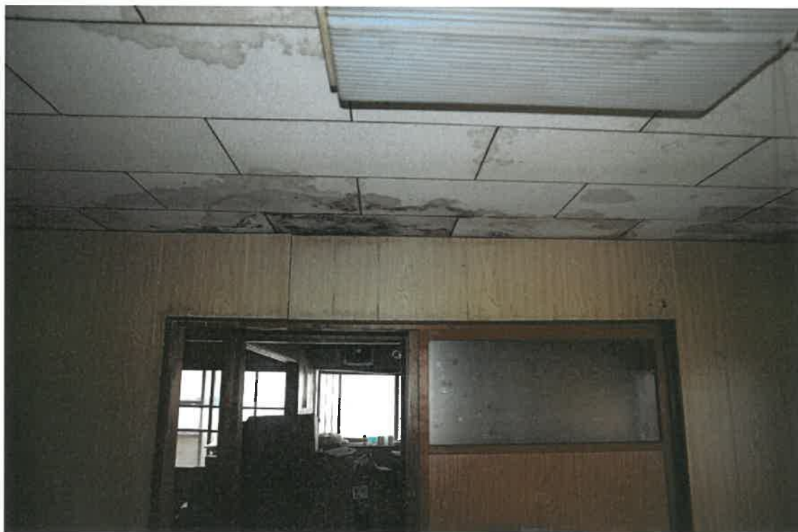
物件 4 建物天井部分の損傷箇所
