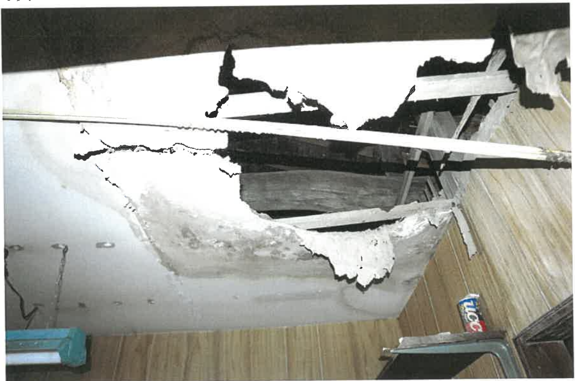
物件 4 建物天井部分の損傷箇所
