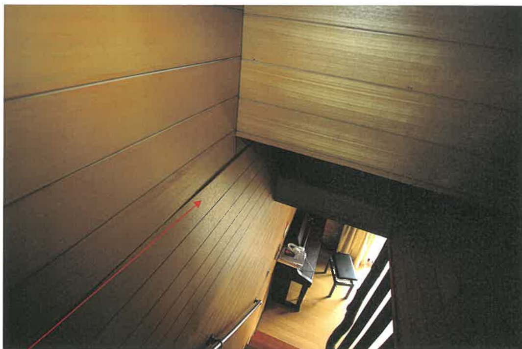
壁面の板が浮いている 物件 3 主建物 1 階から 2 階の階段部分
