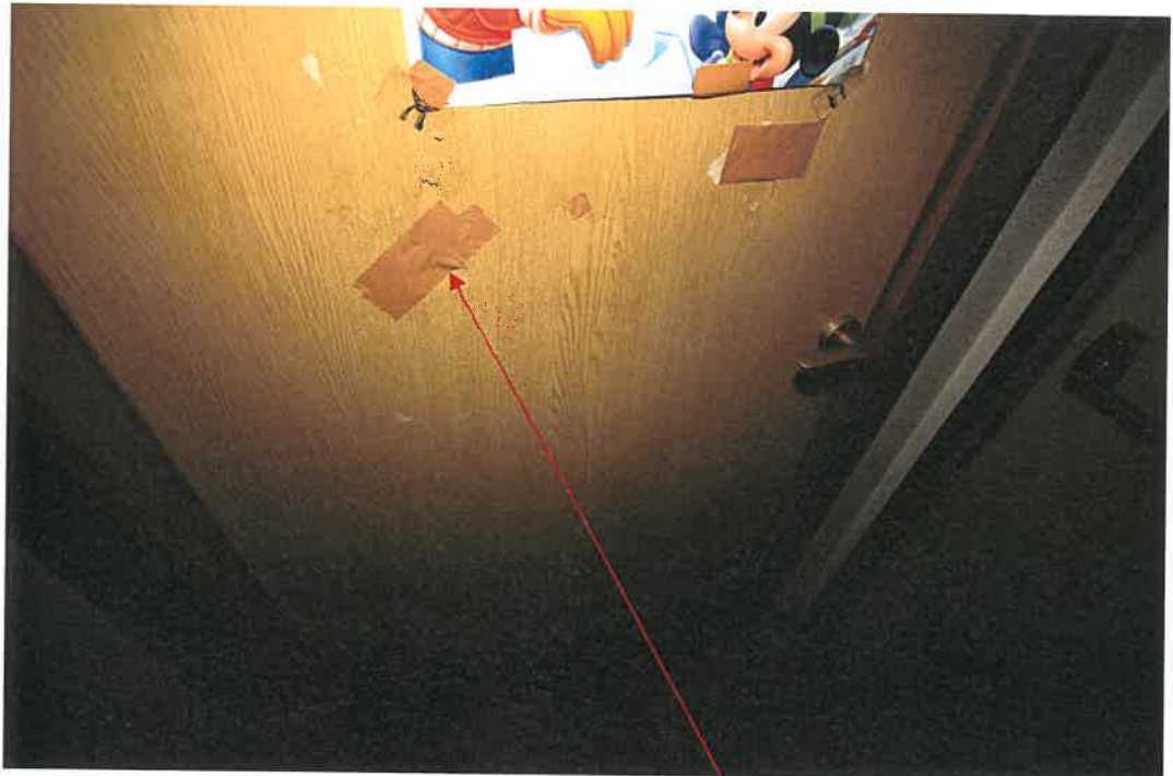
物件 2 建物 2 階室内 扉の穴
