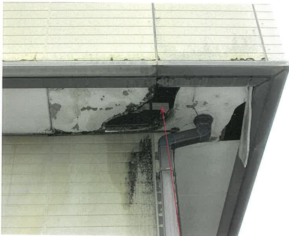
前同建物（ベランダの損傷箇所）
