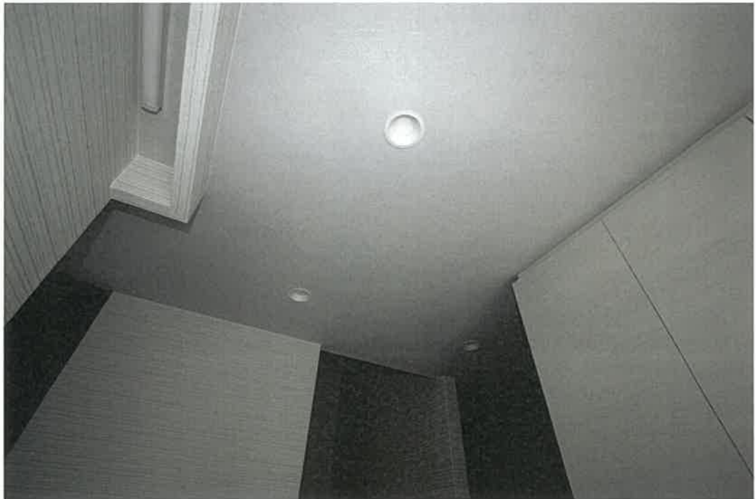
クロスの継ぎ目の浮いている箇所に向けて 物件 2 建物 1 階室内
