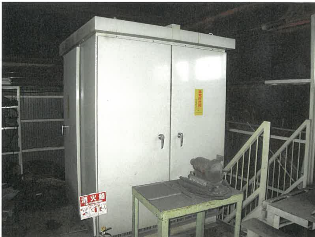
前同建物の1階事務室上の変電設備
