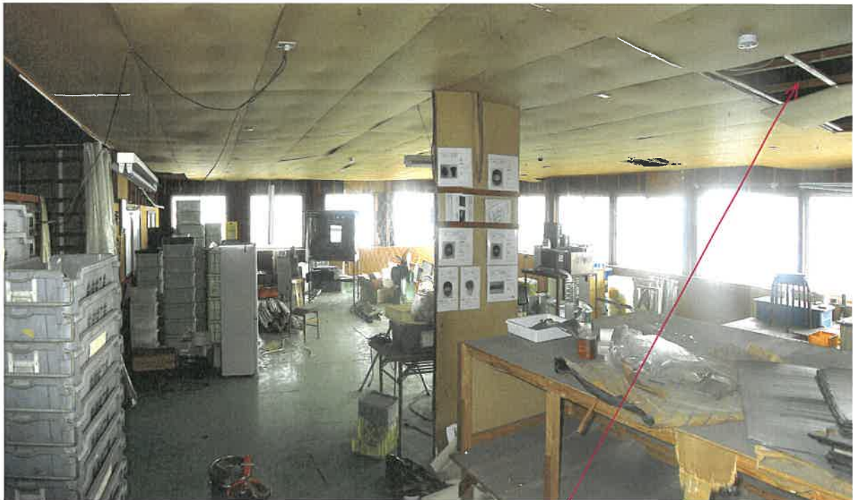
前同建物の2階作業場内（天井の剥離部分）
