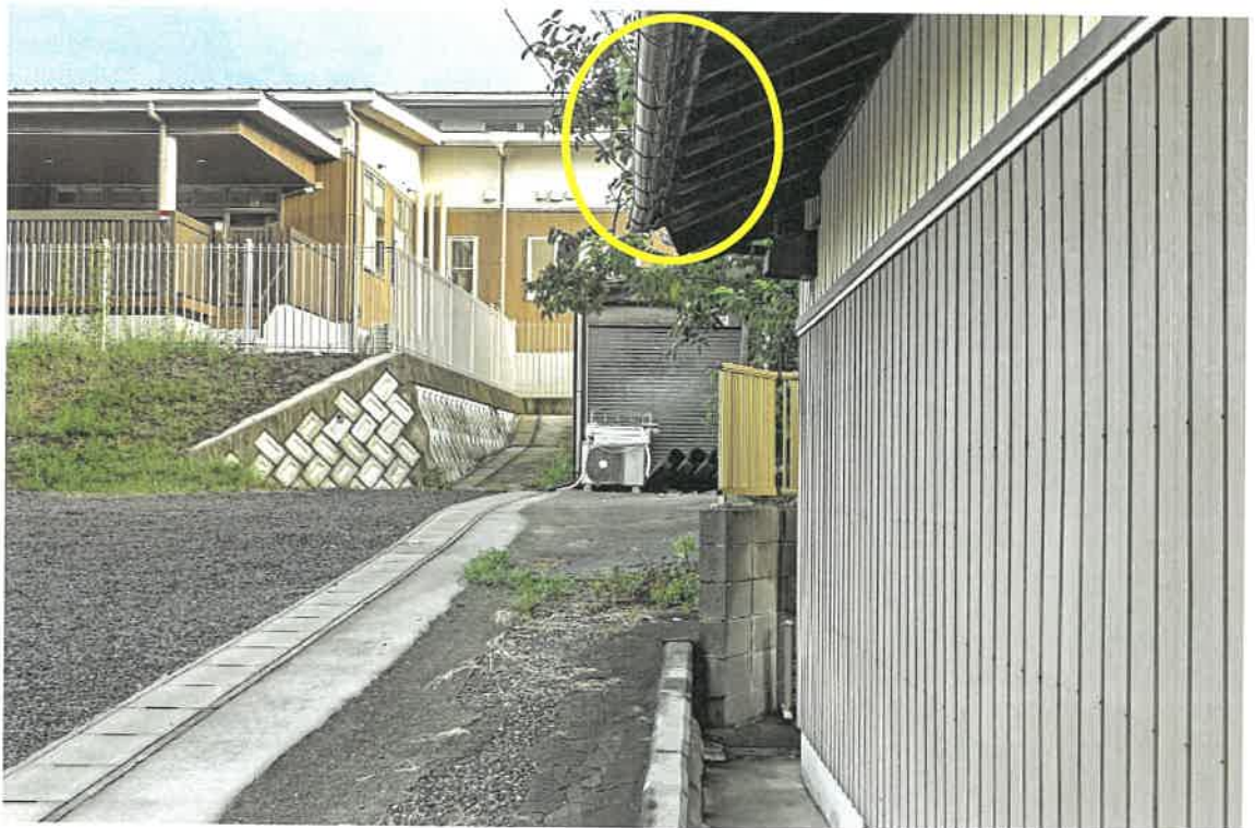
写真 2 4 物件 2 土地竿部分の東側隣地（地番 3 8 番 4）上の建物（家屋番号 3 8 番 4）の屋根の一部分が物件 2 土地上に越境していると思料される状況
