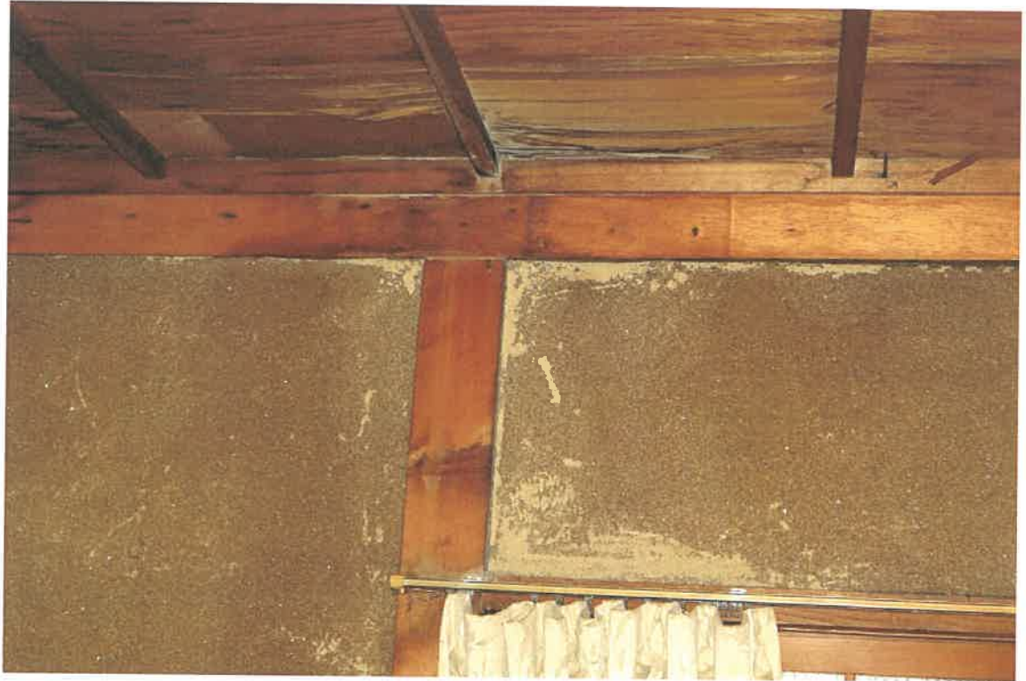
写真 2 3 物件 3 建物 1 階北西側の和室の天井及び壁の損傷状況
