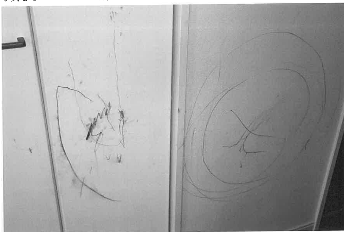
物件2建物1階リビングの扉及び壁の損傷箇所
