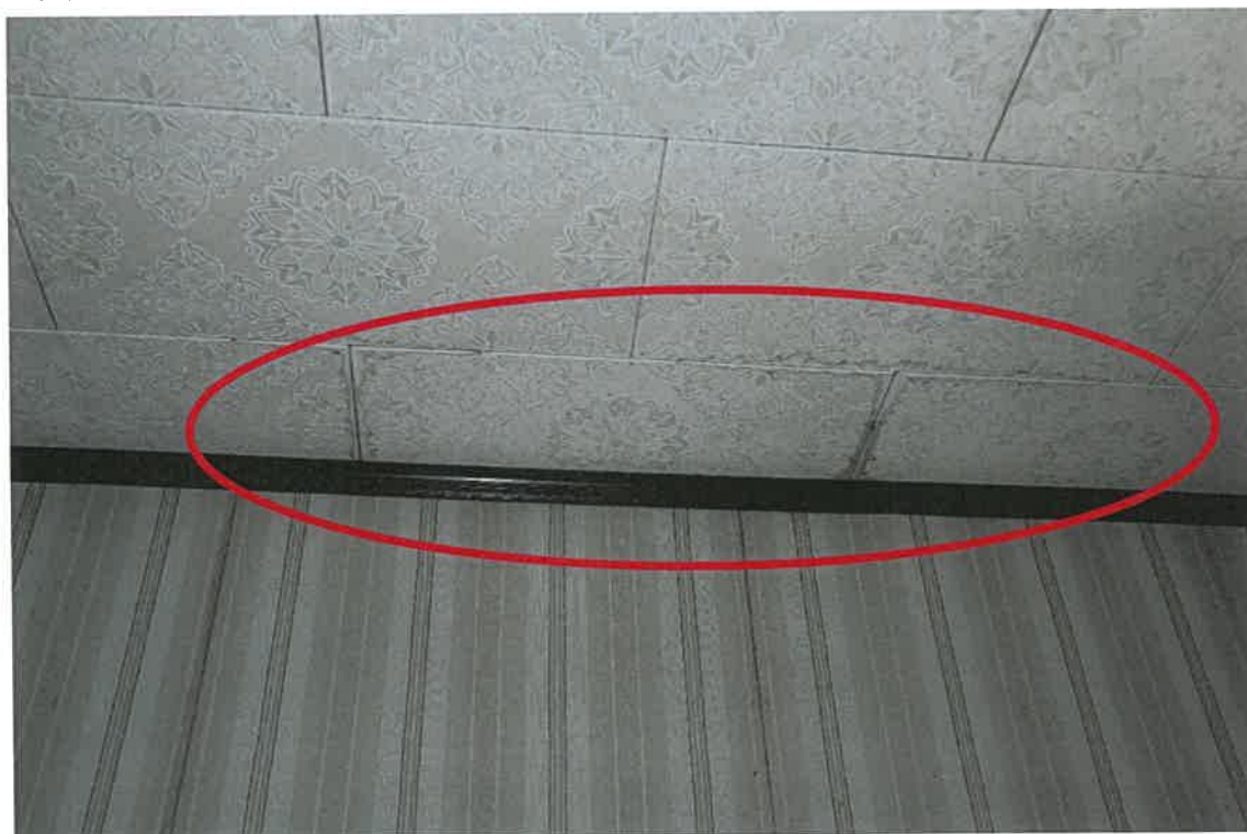
物件3主建物2階天井部分の損傷箇所
