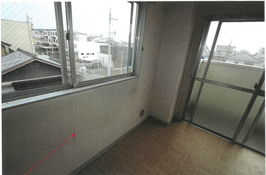
物件 2 建物 3 階 3 0 1 号室 室内 クロスの張り合わせ部分がめくれかけている。
