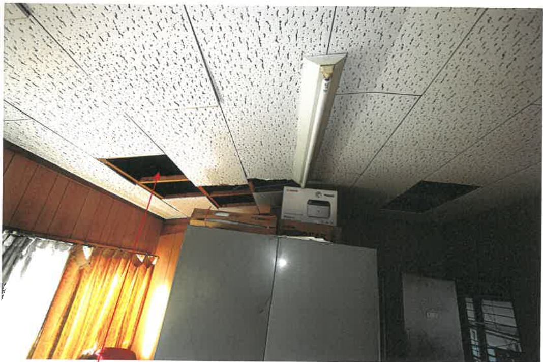
天井が抜けている 物件 3 建物 2 階室内
