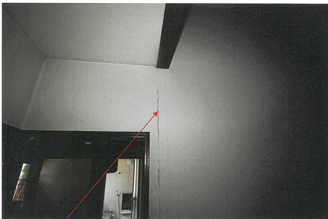
壁にひび割れ
