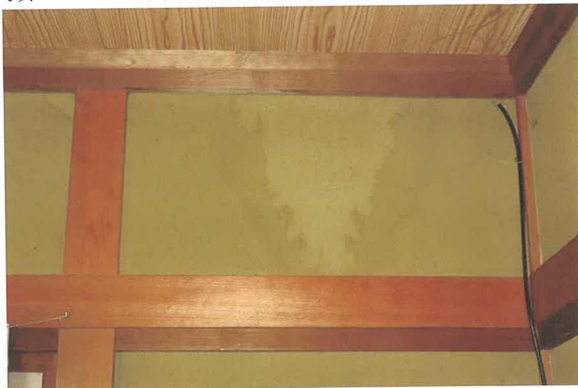
物件3 建物1階和室の壁の損傷状況
