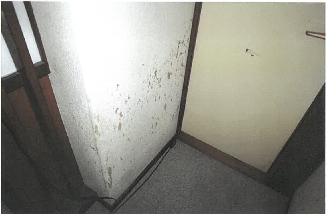
物件 2 建物 1 階廊下壁の損傷箇所
