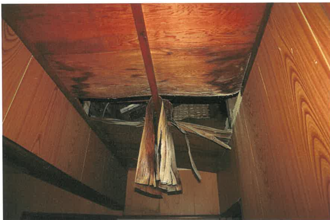
物件 4 建物天井部分の損傷箇所
