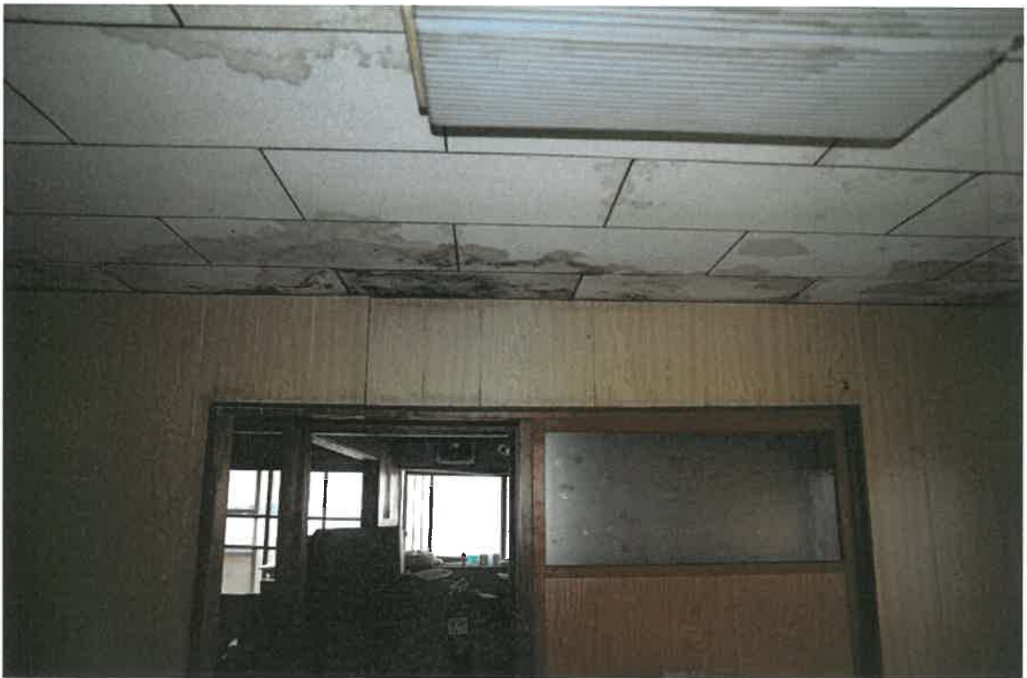
物件 4 建物天井部分の損傷箇所
