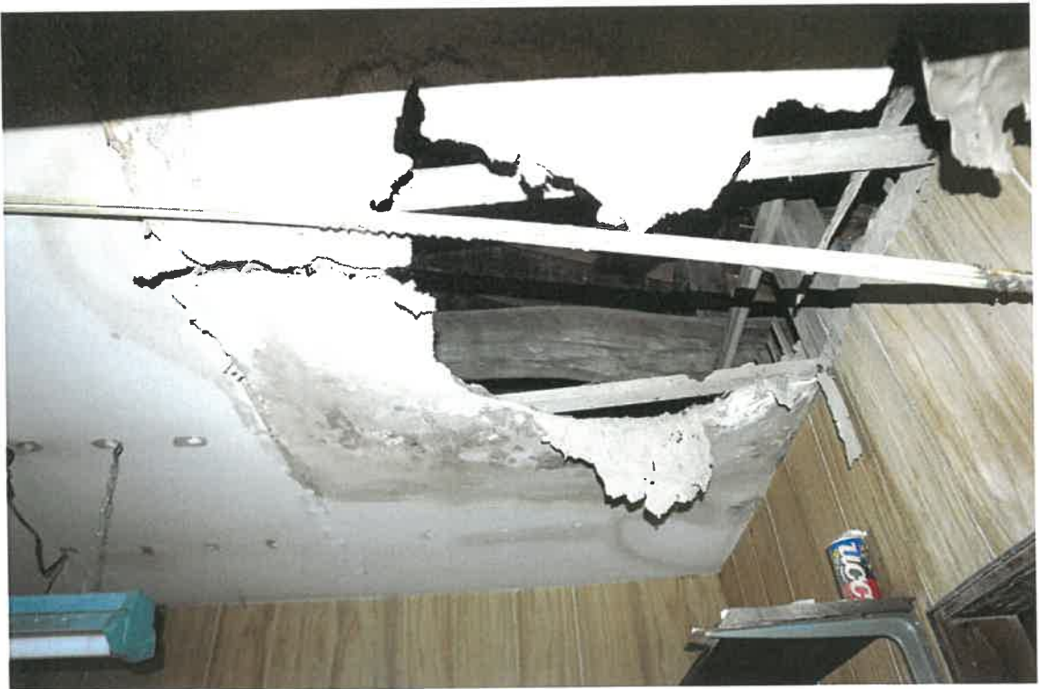
物件 4 建物天井部分の損傷箇所
