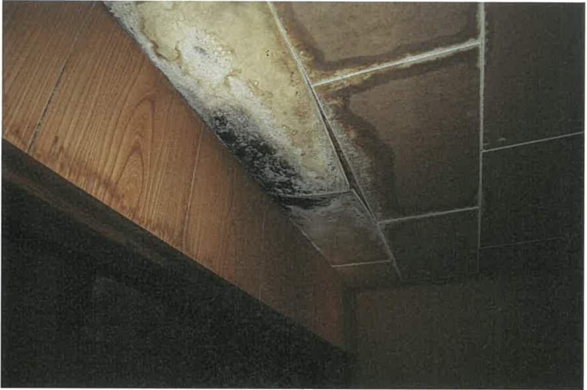
物件 4 建物天井部分の損傷箇所
