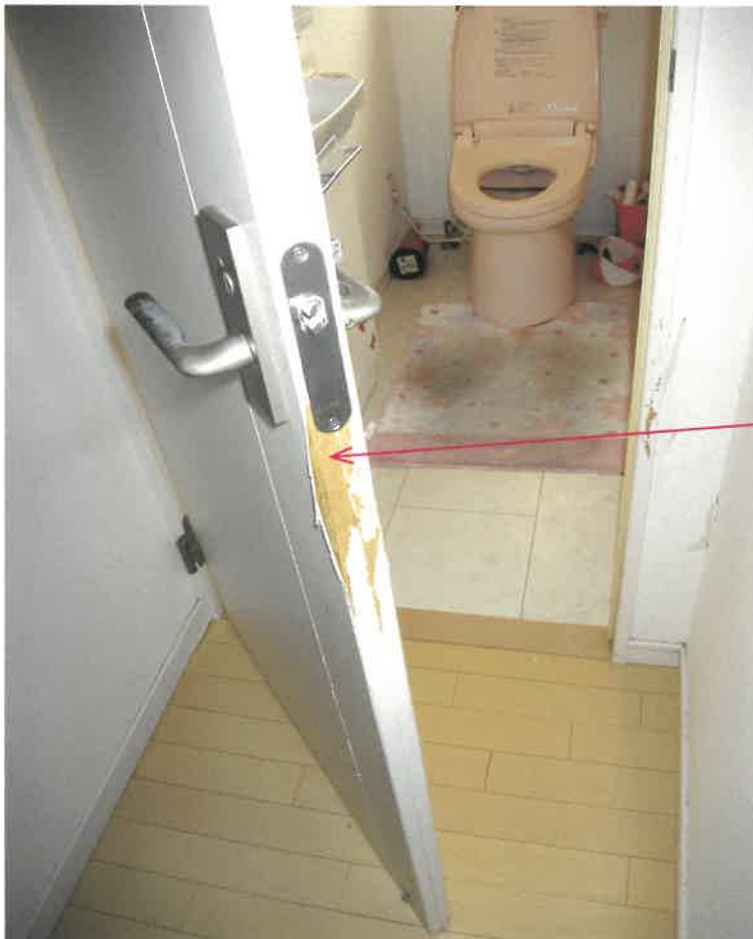
前同建物の2階トイレ (猫の引っかき傷)
