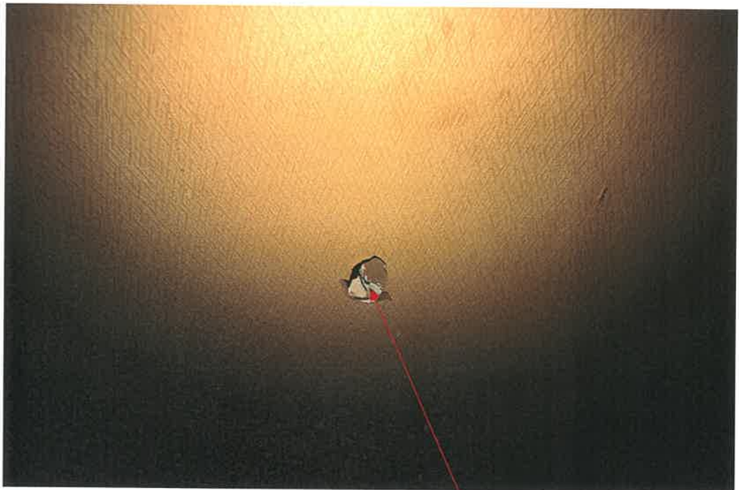
物件 2 建物 2 階室内 壁の穴
