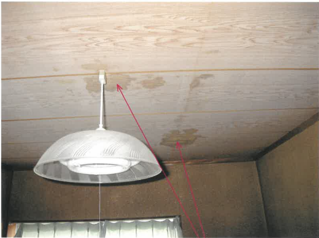
前同建物（西端）の2階室内（天井の染み）
