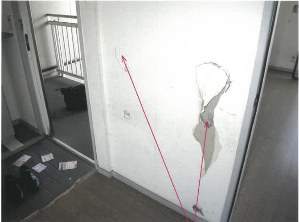
前同建物の203号室内（壁クロスの剥がれ，損傷箇所）
