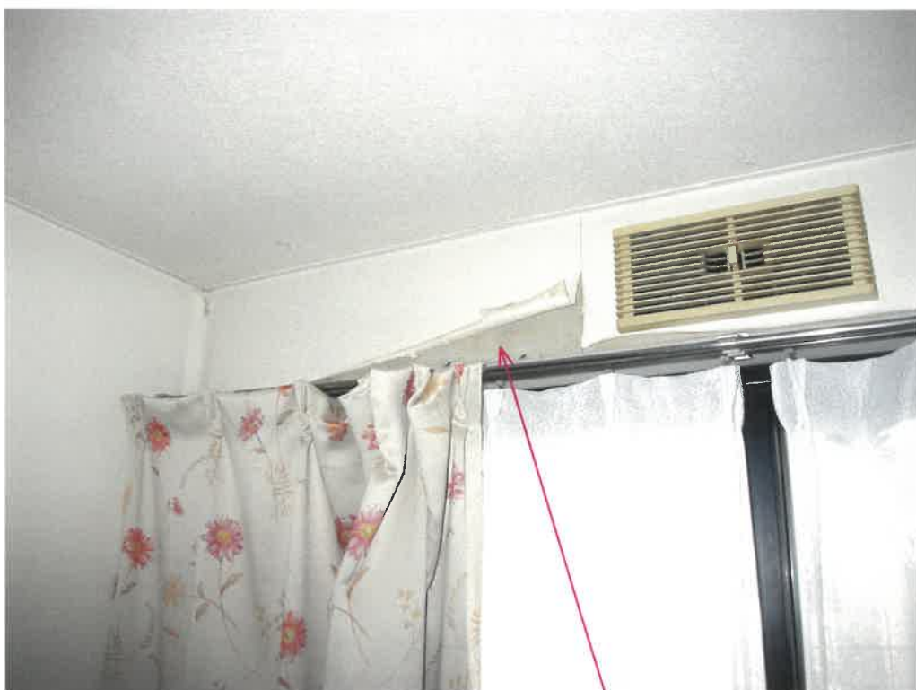
前同建物の102号室内（壁クロスの剥がれ）
