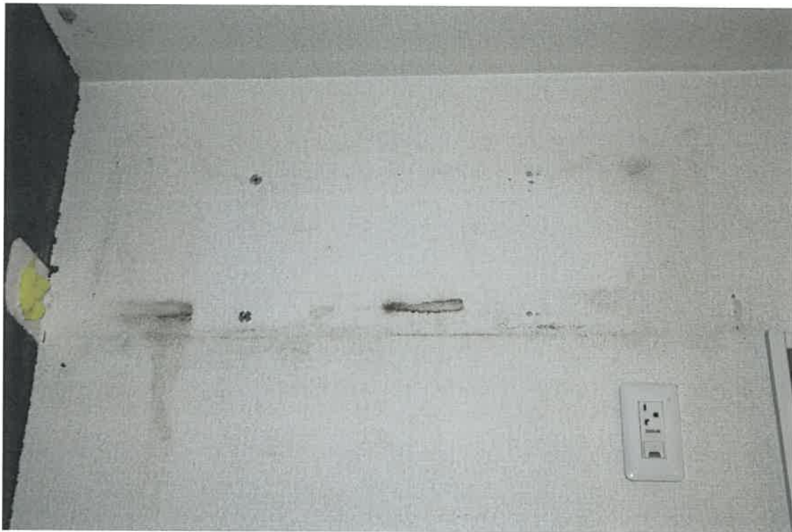
物件 2 建物 1 階リビングダイニングの壁の損傷状況
