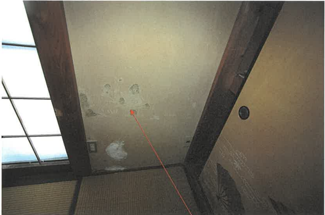
物件 2 建物 1 階室内 犬による傷痕
