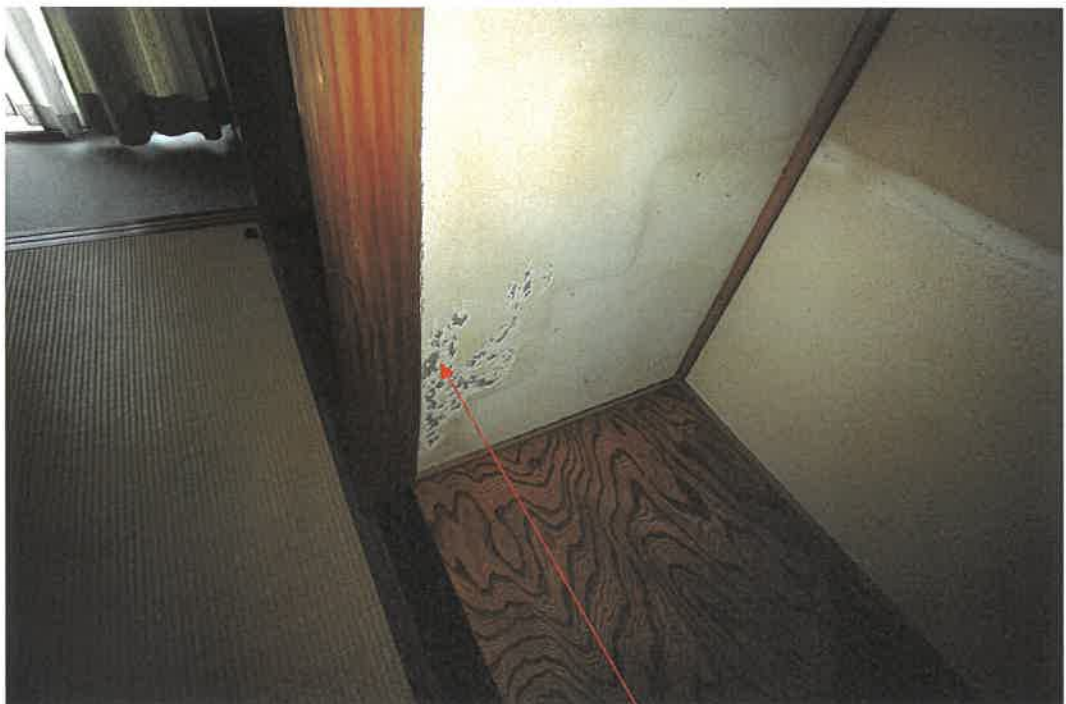
物件 2 建物 1 階室内 犬による傷痕
