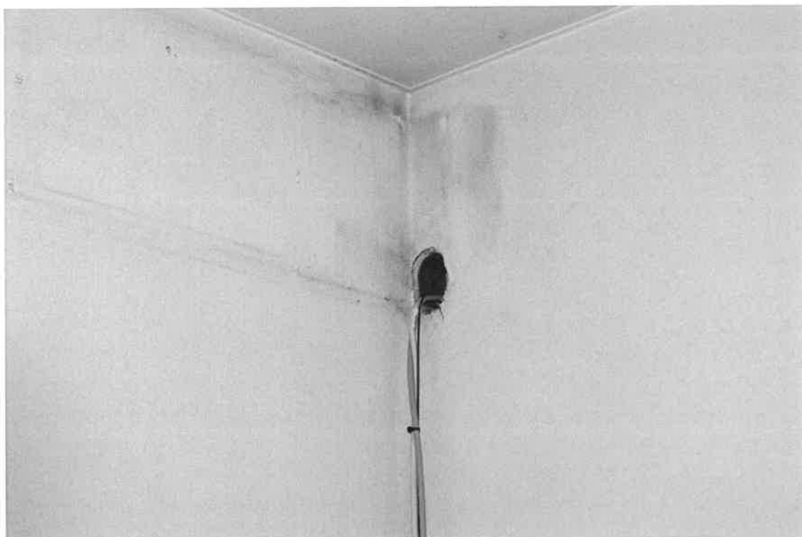
1階リビング壁の損傷状況
