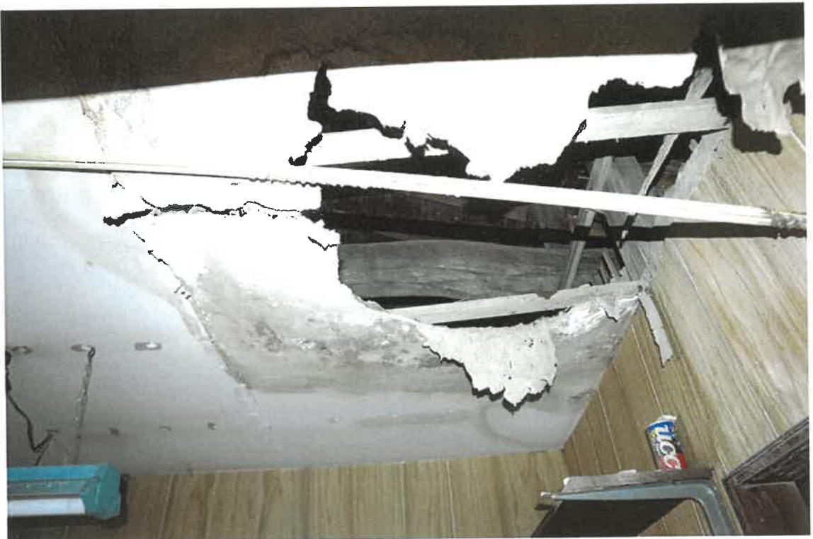
物件4 建物天井部分の損傷箇所
