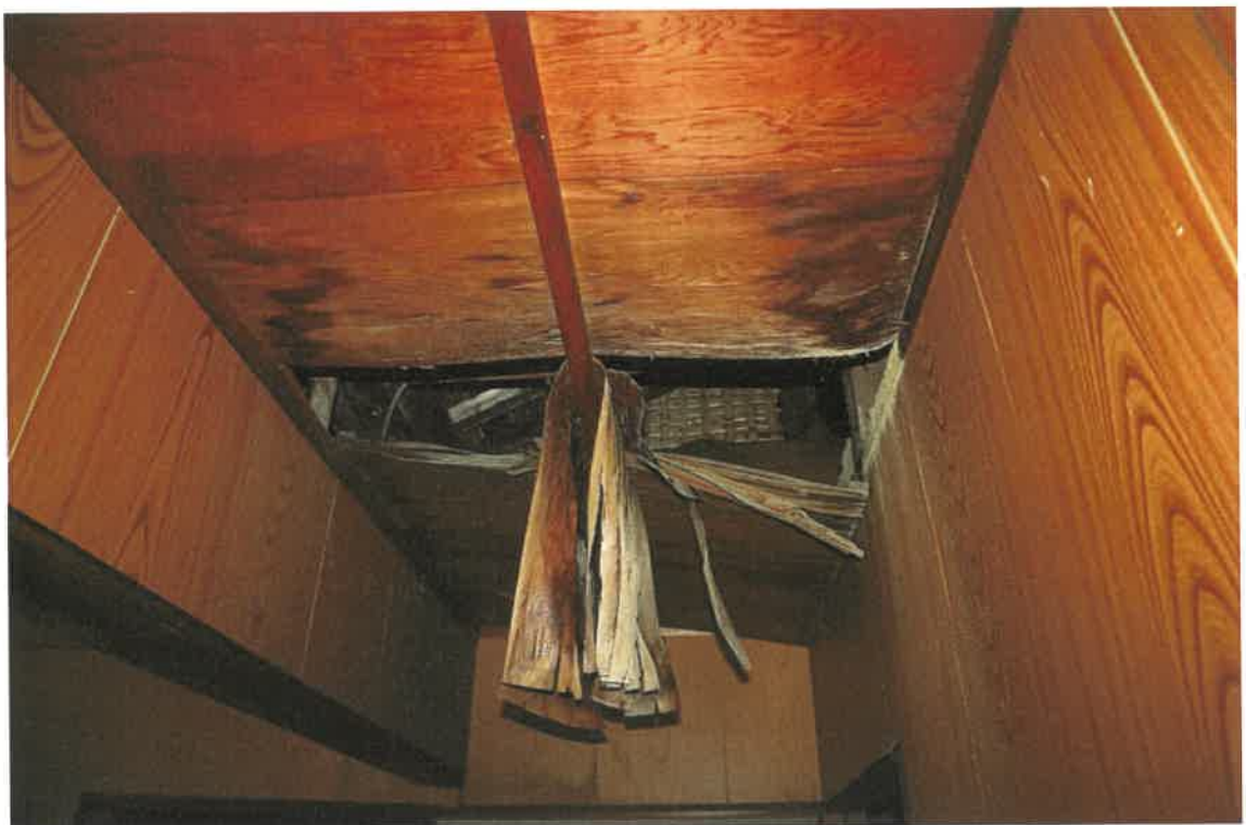
物件4建物天井部分の損傷箇所
