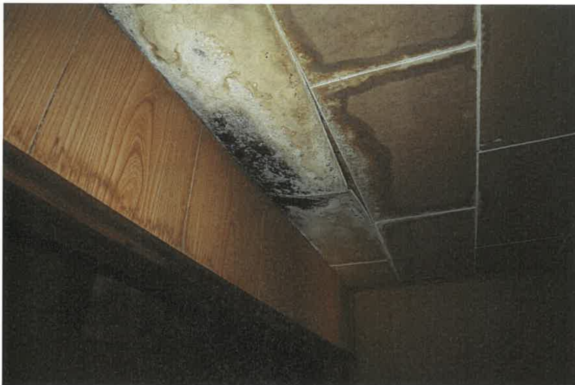
物件 4 建物天井部分の損傷箇所
