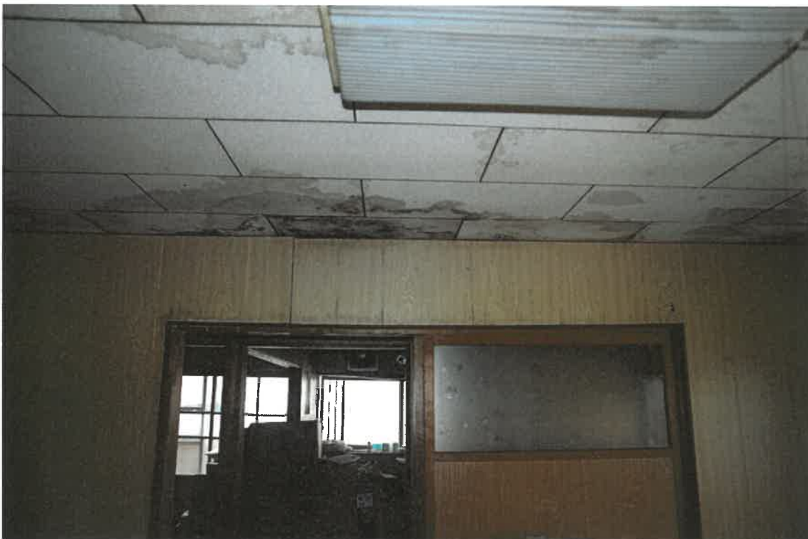
物件 4 建物天井部分の損傷箇所
