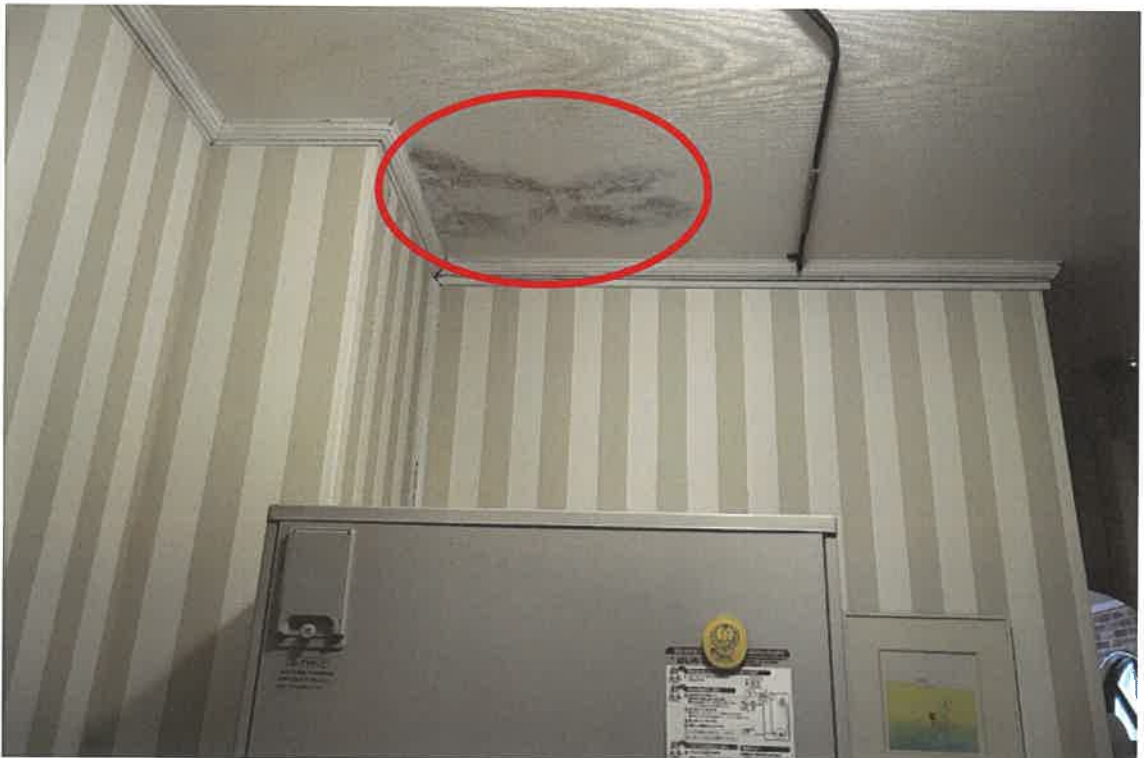
物件2建物2階天井部分の損傷箇所
