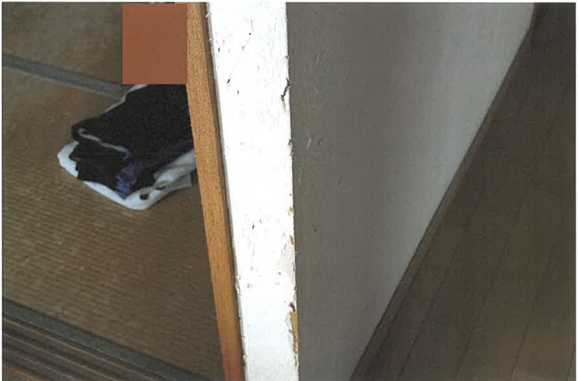
物件1 建物のリビングダイニングの壁の損傷状況
