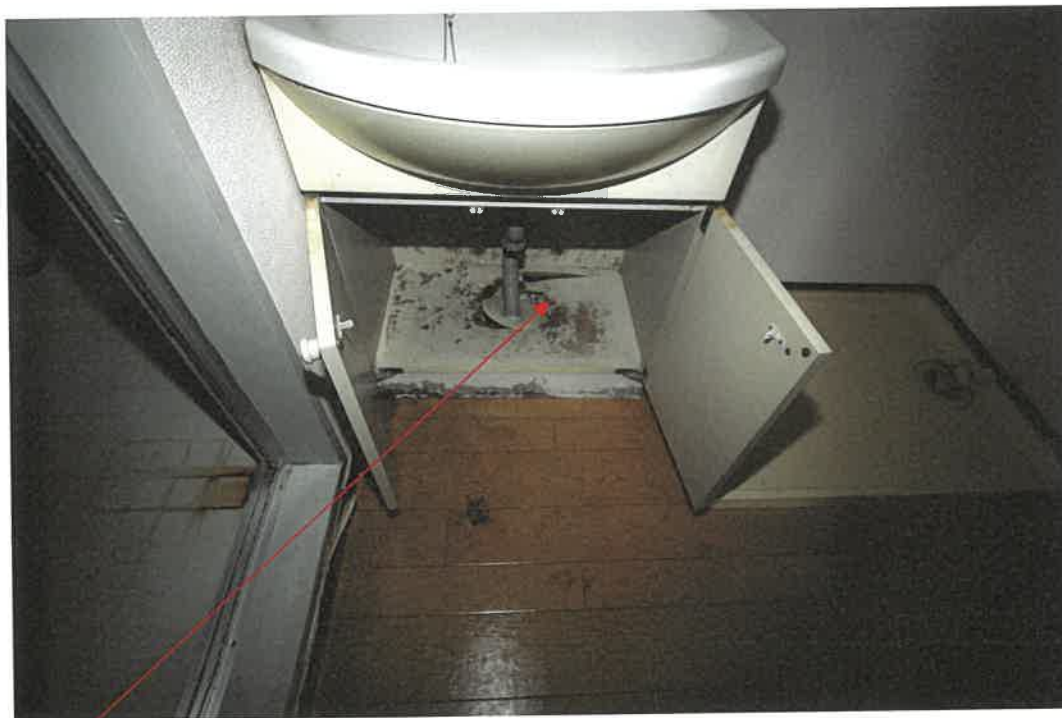
物件 2 建物 3 階 3 0 1 号室 室内 床板が傷んでいる
