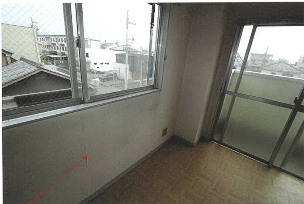
物件 2 建物 3 階 3 0 1 号室 室内 クロス of 張り合わせ部分がめくれかけている。
