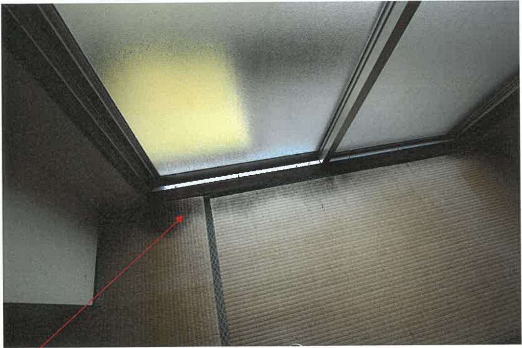
物件 2 建物 2 階 2 0 2 号室 室内 畳が雨のために汚れているように思われる。
