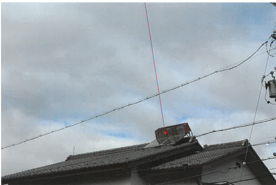
熱温水器の設置状況
