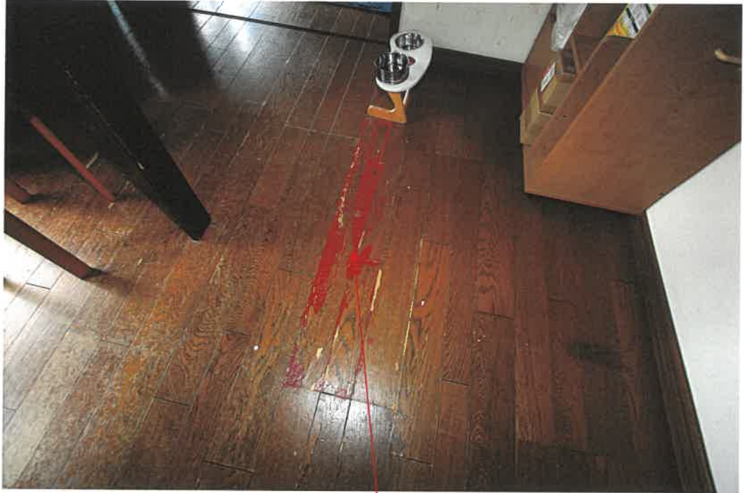
物件 2 建物 1 階室内 フローリングの剥がれ
