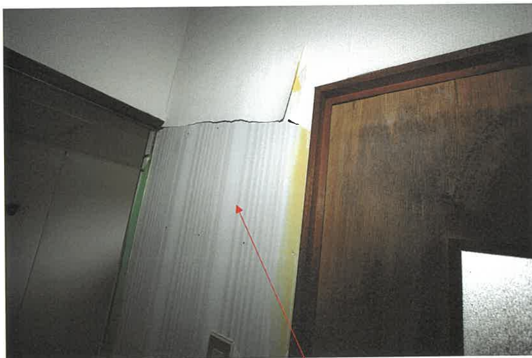
物件 2 建物 室内 クロスの剥がれ
