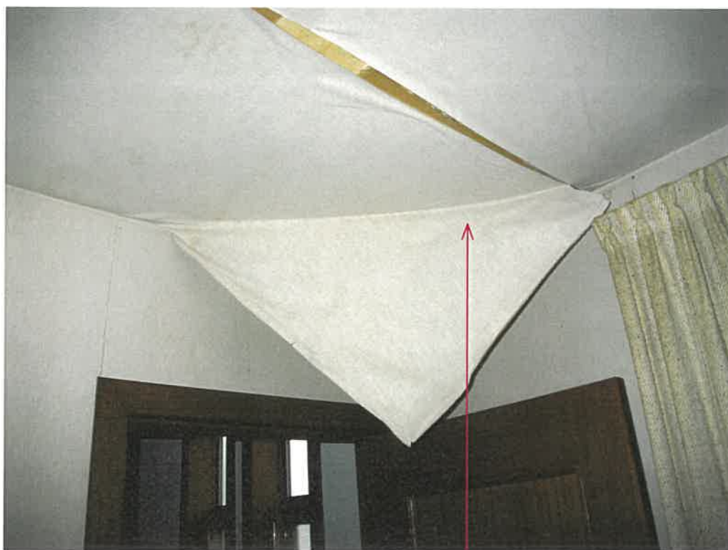
前同建物の2階室内（天井クロスの剥がれ）
