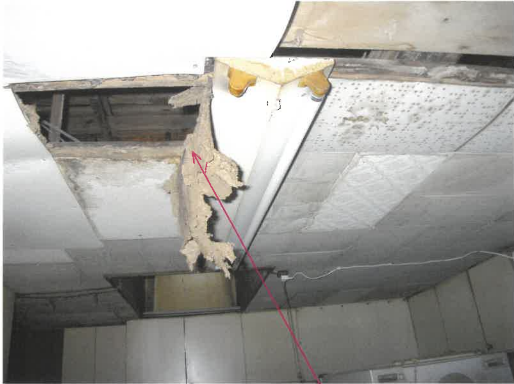
前同建物の1階室内（雨漏りによる剥がれ箇所）
