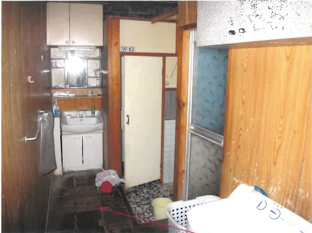
前同建物の1階浴室・洗面所前（床の不安定箇所）
