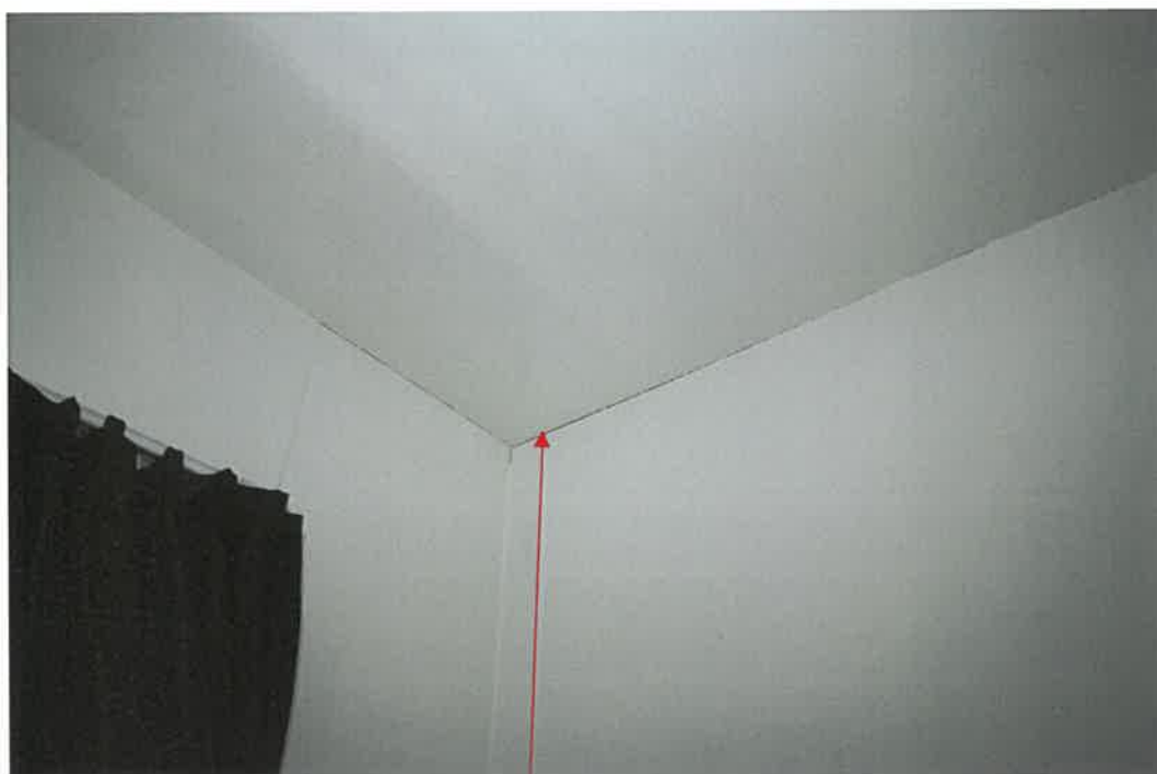
物件 2 建物 2 階室内 壁面と天井との間に亀裂がある
